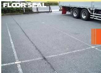
① 駐車場内の目地の劣化が進み段差が発生しています
