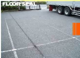
① 駐車場の目地の劣化が進み段差が発生しています
